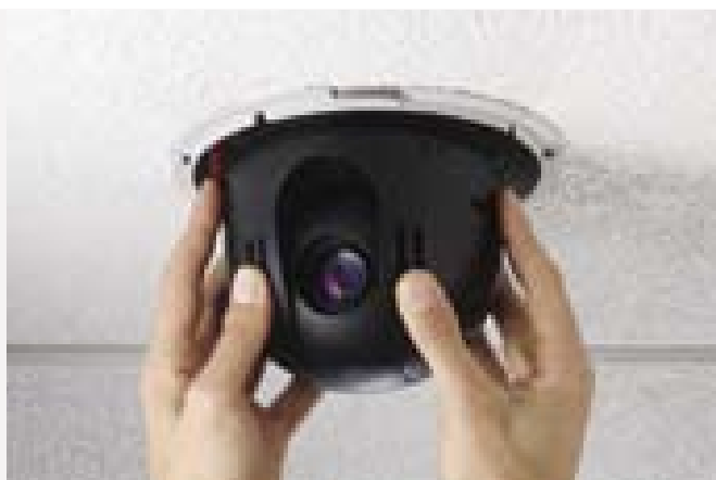
Mettez en place le nouveau module « remplaçable à chaud » ici une caméra mobile...
